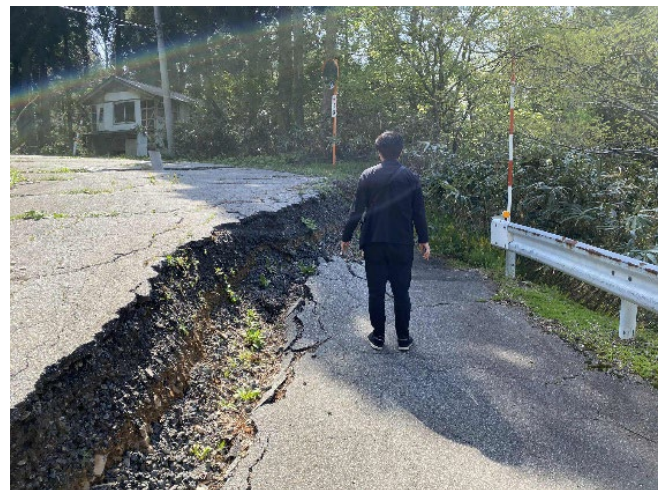
写真2 石川県珠洲市における道路被害（筆者撮影）
