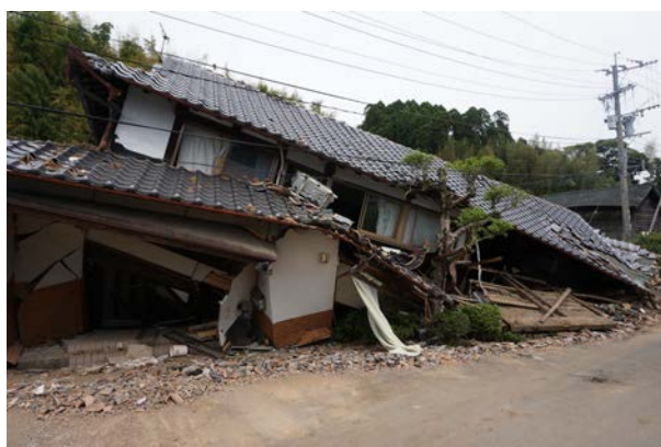
写真 1 母屋の被害 (西原村大切畑)
