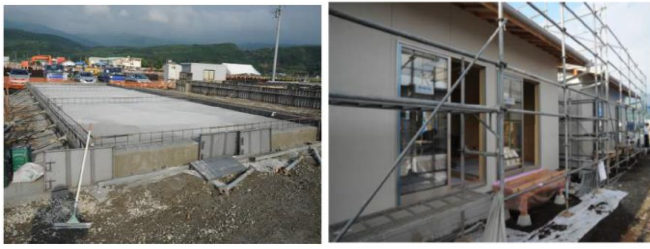
図2 熊本県西原村木造仮設基礎 図3 同建設中の木造仮設住宅 出典：岩田司「熊本地震被害調査報告書」15)
